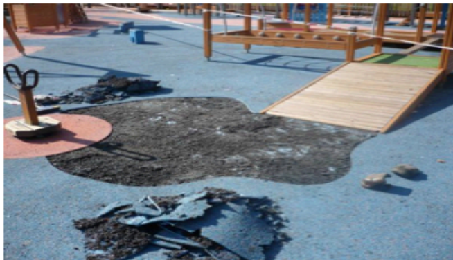
Zona a reparar
